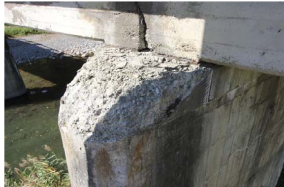
写真4-35 橋脚部コンクリートの剥離
