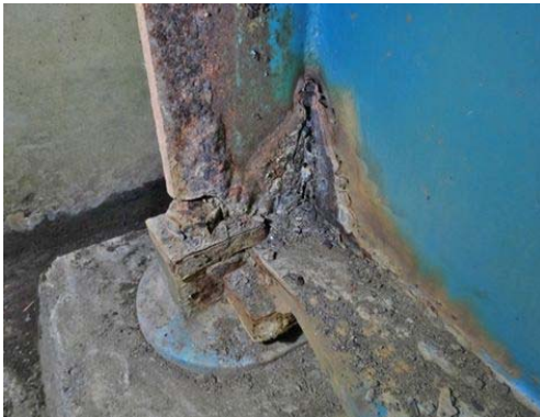
写真4-34 主桁端部の腐食
